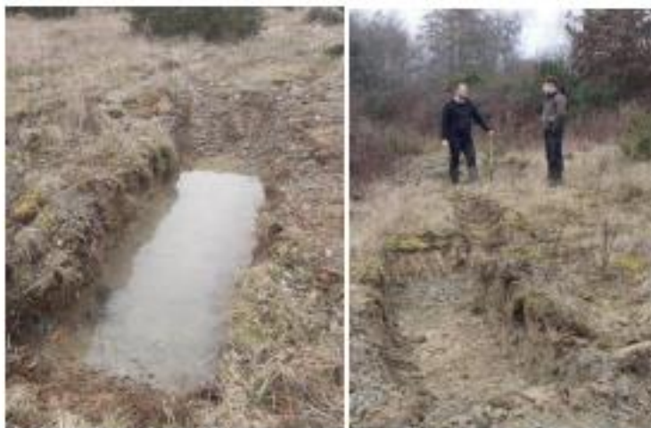
Après le passage de la pelle mécanique, les bénévoles adoucissent les «berges» des arrières
